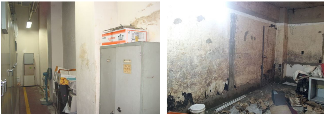
(a) 누수로 인한 벽면 오염
