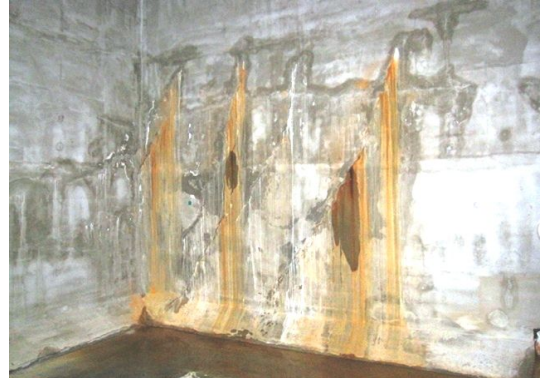
[사진 1.1] 누수로 인한 구조물의 손상
